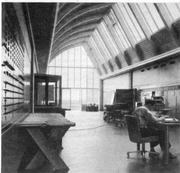
Bild 3. Senderraum; rechts an der Wand die beiden Telefunken-Sender, links das Antennen-Schaltfeld (BBC)
